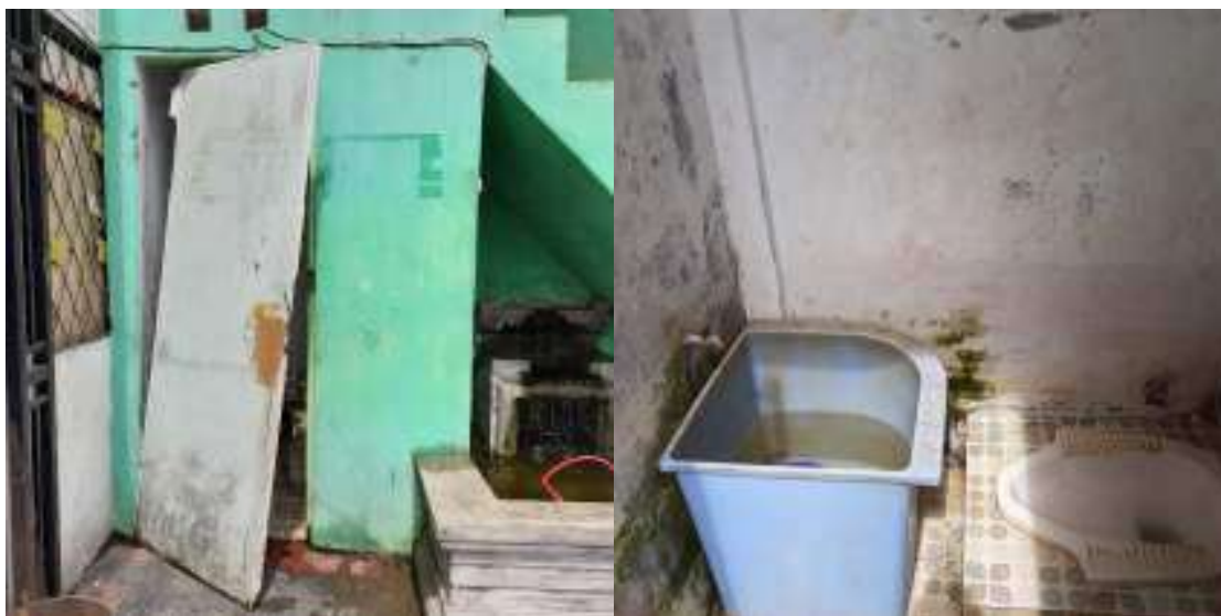
Gambar 1.2. Kondisi Toilet untuk Guru di SD Swasta Pembangunan
