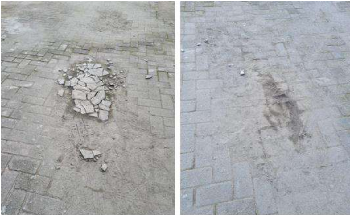
Kondisi paving blok yang rusak
