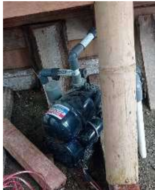
Gambar 3.1 Sumur bor dan pompa air untuk pemenuhan kebutuhan air di SD Swasta Pembangunan
