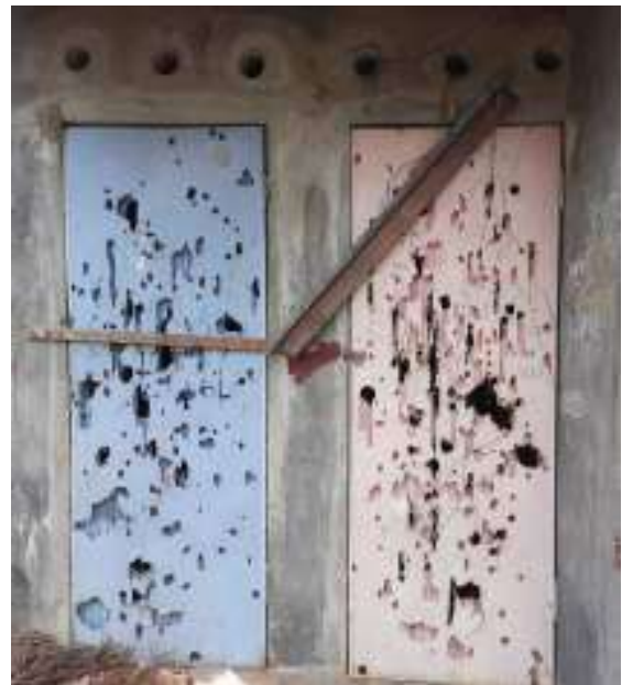
Gambar 1.1. Kondisi Toilet Siswa di SD Swasta Pembangunan
