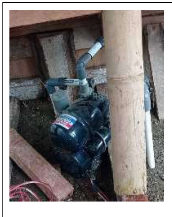
Gambar 4.4 Sumur bor dan pompa air untuk pemenuhan kebutuhan air di SD Swasta Pembangunan
