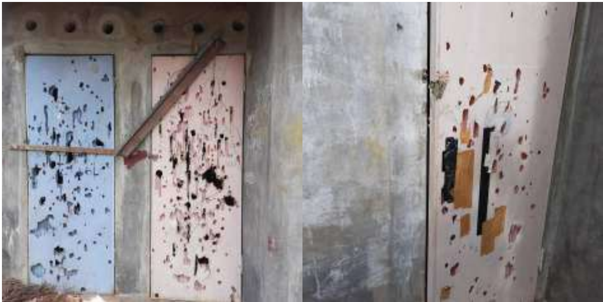
Gambar 1.1. Kondisi Toilet Siswa di SD Swasta Pembangunan
